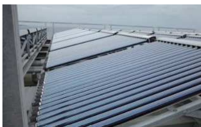
実測調査予定の大規模太陽熱温水器(触媒循環型間接加熱方式)
