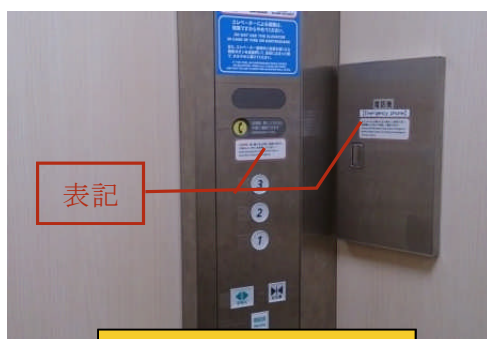
EV内 操作パネル
