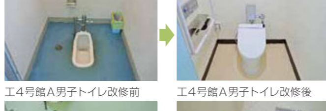
工4号館A男子トイレ改修前 工4号館A男子トイレ改修後
