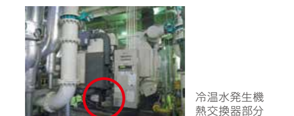
冷温水発生機 熱交換器部分
