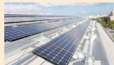
おきなわクリニカルシミュレーションセンター太陽光発電設備(定格容量 20kW)
