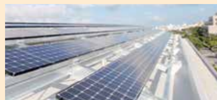
おきなわクリニカルシミュレーションセンター太陽光発電設備(定格容量20kW)
