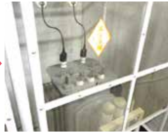
教育学部本館電気室(休止後)
