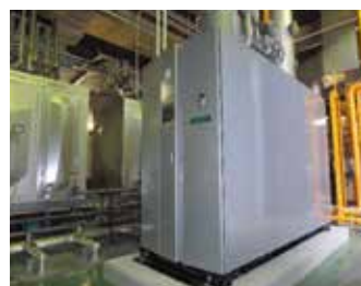
多管式小型貫流ボイラー
