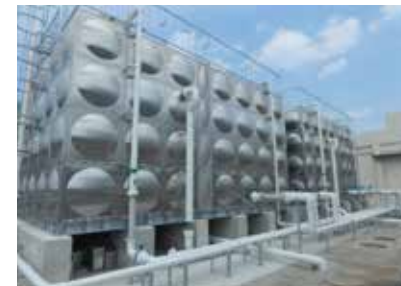
SUSパネルタンク 有効容量：150m³ 2基 槽内に仕切り板を設置し、流入管の位置も工夫することで、槽内で塩素濃度ムラを防ぎます。
