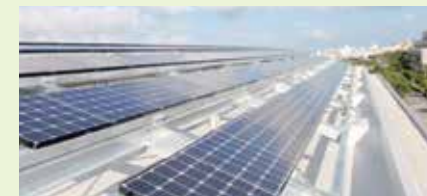
おきなわフロンティアシミュレーションセンター太陽光発電設備(定格容量20kW)
