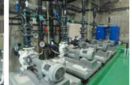
サンプリングポンプ・薬注ポンプ
