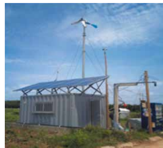
ハイブリッド発電システム (風力2.5kW, 太陽光2kW)
