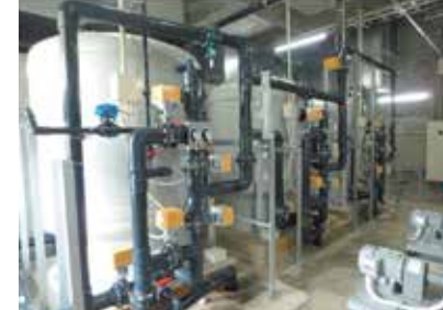
除濁濾過装置・活性炭ろ過装置・硬水軟水化装置 (処理能力:25m³/h)
