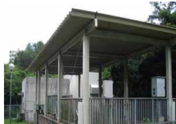
圧送ポンプ場
