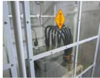
教育学部本館電気室(休止前)
