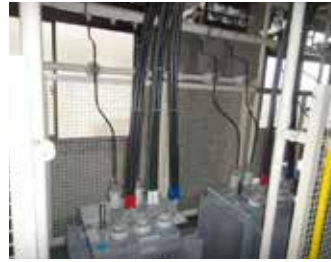
工学部1号館電気室(休止前)
