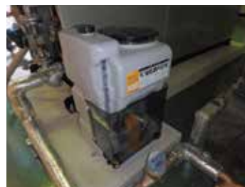
薬注タンク・ポンプ
