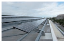
屋上に太陽光パネルを設置して節電対策 (おきなわクリニカルシミュレーションセンター)
