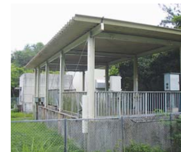
圧送ポンプ場
