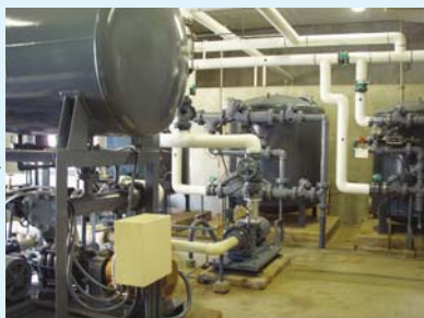
専用の濾過装置にて、濾過・消毒処理
