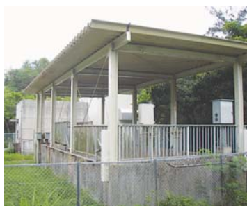
圧送ポンプ場
