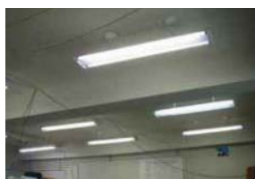
写真1 取替前の照明器具
