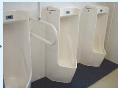
千原団地の各建物トイレの洗浄水として有効利用
