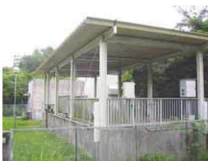
公共下水道へ排水をする圧送ポンプ場
