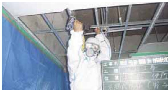
アスベスト含有材の撤去状況(ボードを割らないようにビスを外し撤去)
