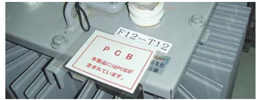
PCB混入を示す表示板
