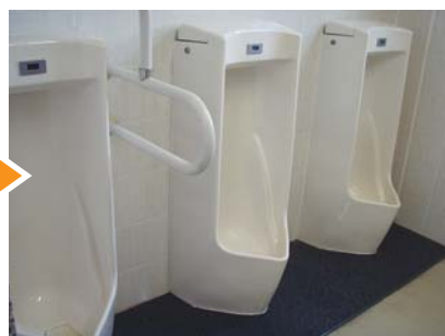
千原団地の各建物便所の洗浄水として有効利用
