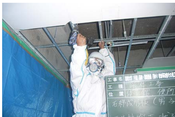
アスベスト含有材の撤去状況（ボードを割らないようにビスを外し撤去）
