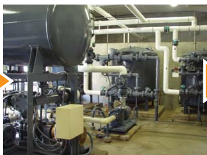
専用の濾過装置にて、濾過・消毒処理をする。
