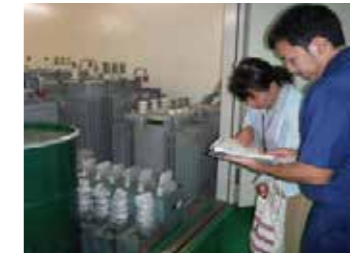
沖縄県南部福祉保健所による PCB 廃棄物保管状況現場調査
