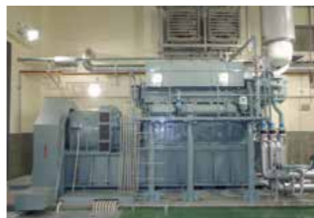
上原団地:自家用発電機(1号発電機)
