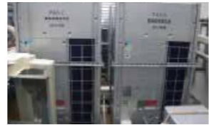
室外機(更新後)
