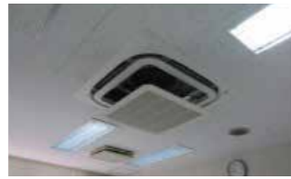
天井カセット型エアコン&自動昇降パネル
