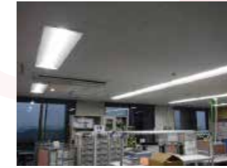
室内機(更新前)
