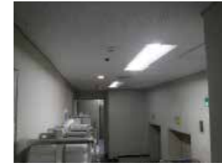
室内機(更新後)
