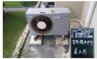
室外機(更新前)
