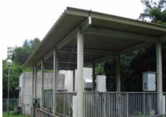
圧送ポンプ場
