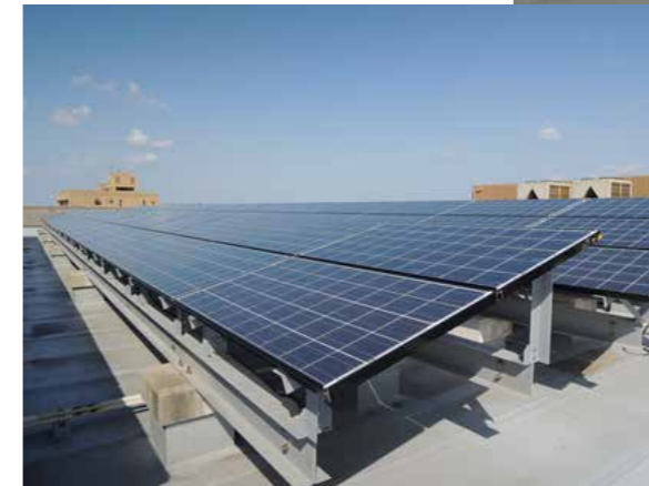
図書館屋上太陽光発電設備(定格容量80kW)
