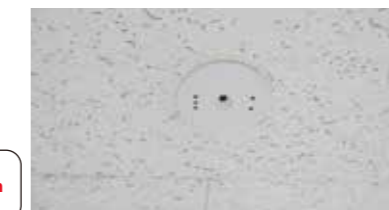
光センサー: 外光を感知して窓際の照明の明るさをコントロールします
