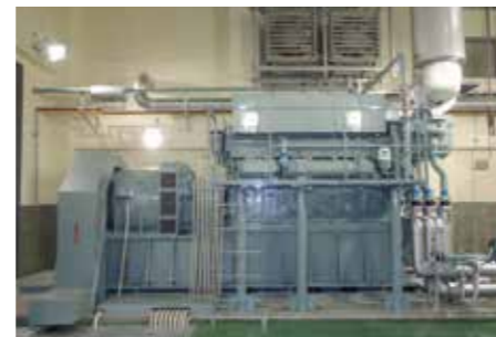
上原団地:自家用発電機(1号発電機)
