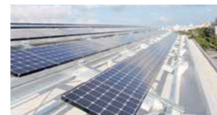
おきなわクリニカルシミュレーションセンター太陽光発電設備(定格容量20kW)
