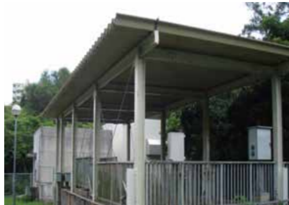
圧送ポンプ場
