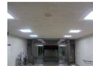
玄関ホール LED照明
