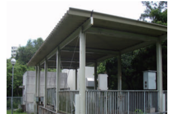
圧送ポンプ場
