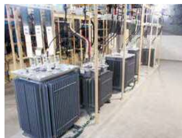
農学部校舎の変圧器
